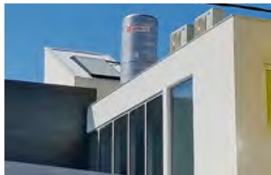
La prensa de la región fue invitada a conocer los avances en materia de sustentabilidad ambiental desarrollados en los Nuevos Laboratorios. En la nota gráfica se observan los paneles que se complementan con los termotanques solares para la provisión de agua caliente.
